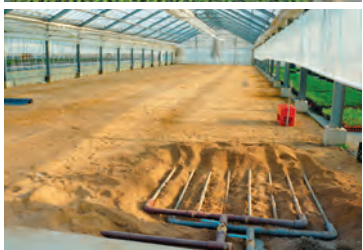
(有)オニヅカバイオシステムのハウスの地下には、温水管を通した床暖房が完備。
